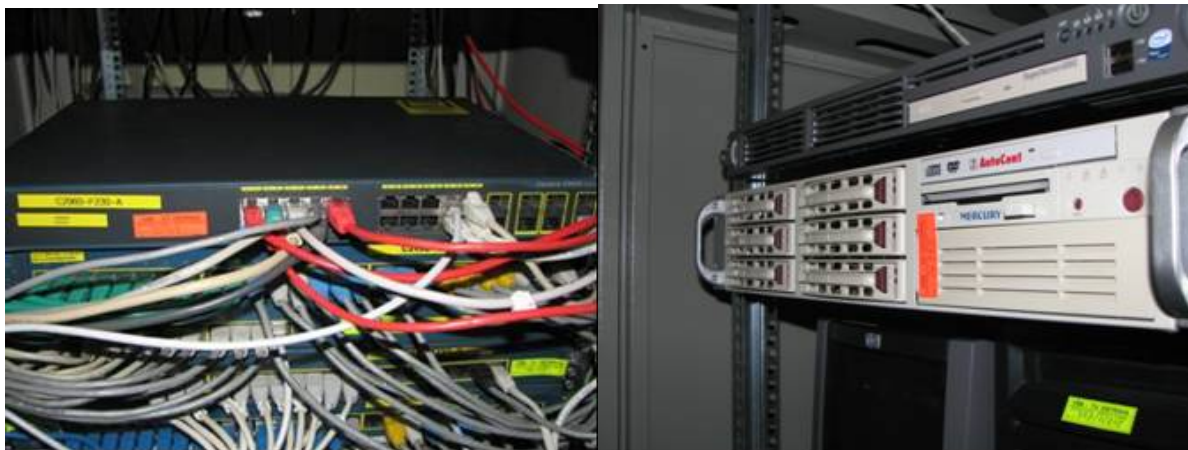
Obr. 1 – Cisco switch Catalyst a server umístěný ve skříní typu rack
